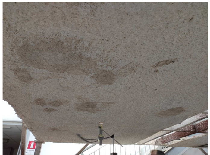
Fotografia dell'intradosso dopo il secondo impatto zona di prova "A"
