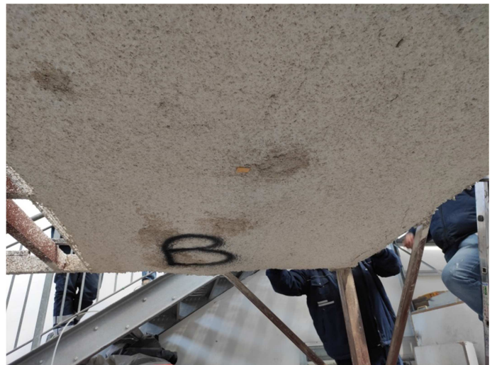
Fotografia dell'intradosso dopo il primo impatto zona di prova "B"
