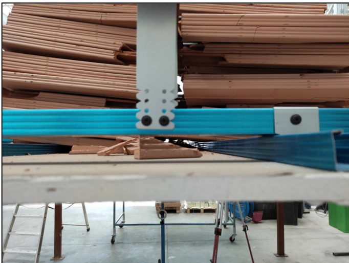
Particolare della flessione del traverso
